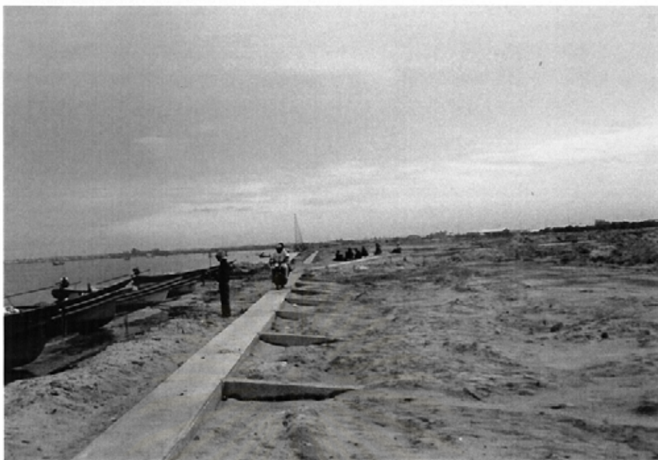
รูปที่ 3. บริเวณชายฝั่งใกล้กับแหลมนก (บริเวณที่ศึกษา) จะมีการถมทะเล โดยการสร้างทำนบกอนกรีตกัน และมีการนำดินมาถม เพื่อขยายเขตพื้นที่ทำเทียบเรือประมง.
