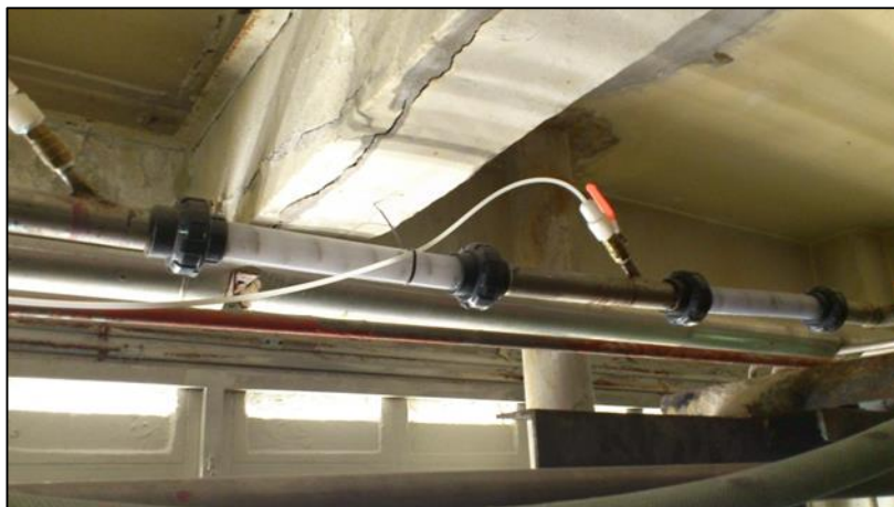
รูปที่ 4. 5 อุปกรณ์ Static mixer ติดตั้งที่ระบบเคมี Coating
