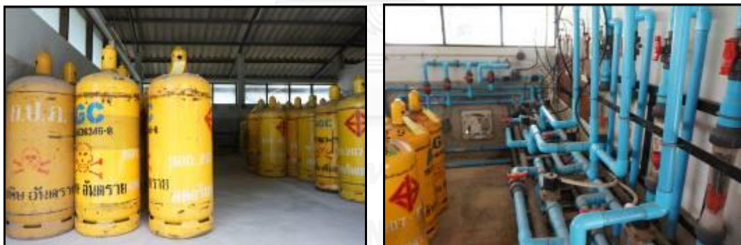
รูปที่ 4.12 ถังก๊าซคลอรีนและการเติมคลอรีนของการประปาส่วนภูมิภาคสาขาเชียงราย
