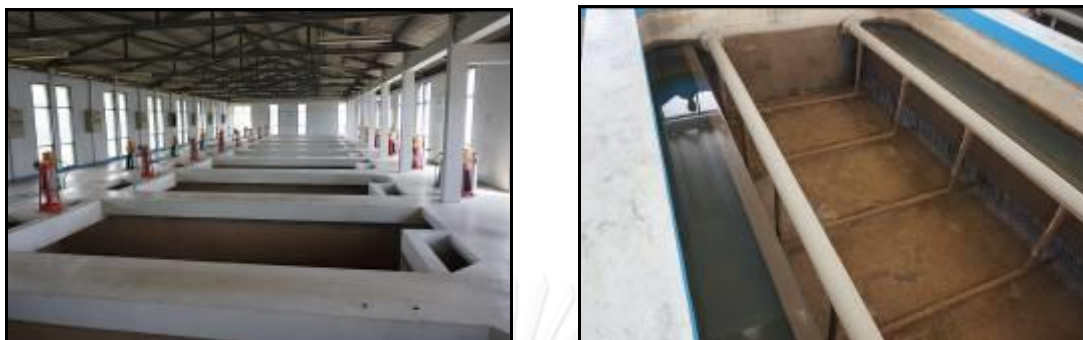
รูปที่ 4.11 ถังกรองทรายของการประปาส่วนภูมิภาคสาขาเชียงราย
