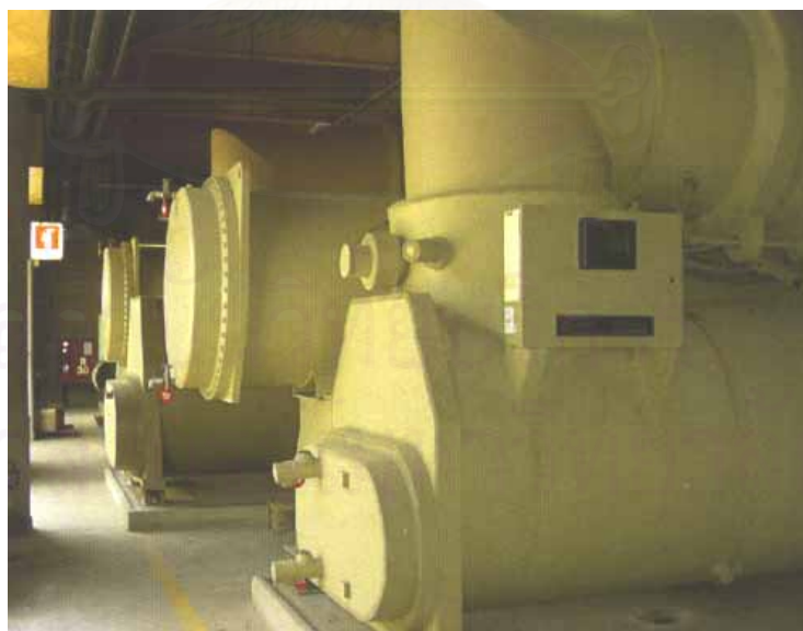
รูปที่ ข.6 แสดงเครื่องทำน้ำเย็นประสิทธิภาพสูงในโรงงานไทยซีอาร์ที
