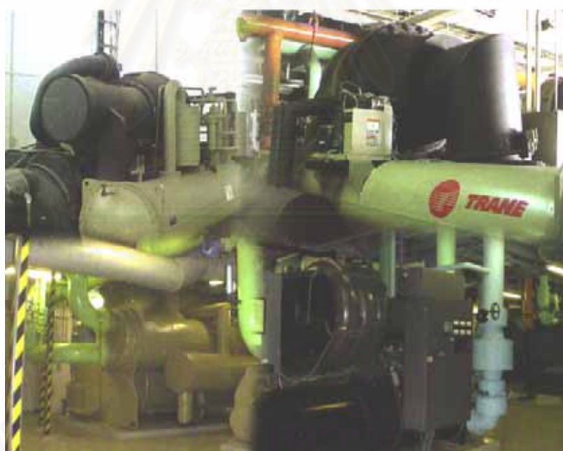
รูปที่ ข.4 การใช้เครื่องทำน้ำเย็นประสิทธิภาพสูง (High Efficiency Chiller)
