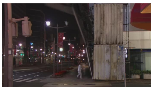
ภาพที่ 4.1.2 ทสึคุโมะประสบอุบัติเหตุจากรั้วกั้นเขตก่อสร้างหล่นทับ
