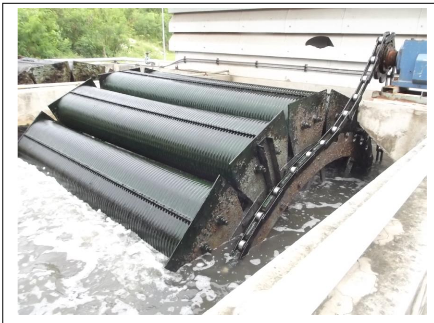
รูปที่ 1.1 ระบบบำบัดน้ำเสีย
