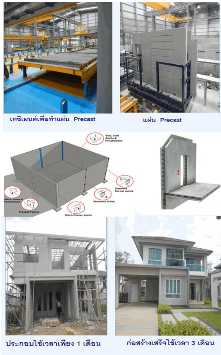
ภาพที่ 3.10 แสดงการติดตั้งผนังคอนกรีตสำเร็จ (Precast ) หน้า 3 นี้
