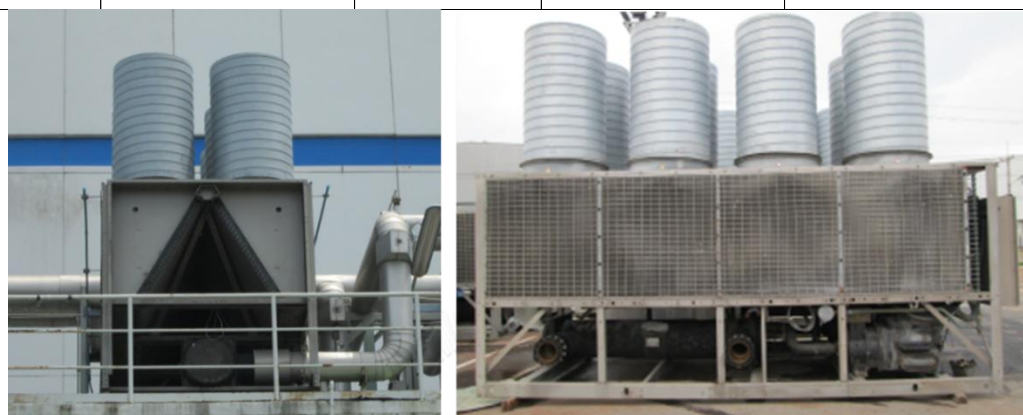
รูปที่ 5.1 ก่อนการปรับปรุงมาตรการ 1 (เปลี่ยนไปใช้เครื่องทำความเย็นที่มีประสิทธิภาพสูง)
