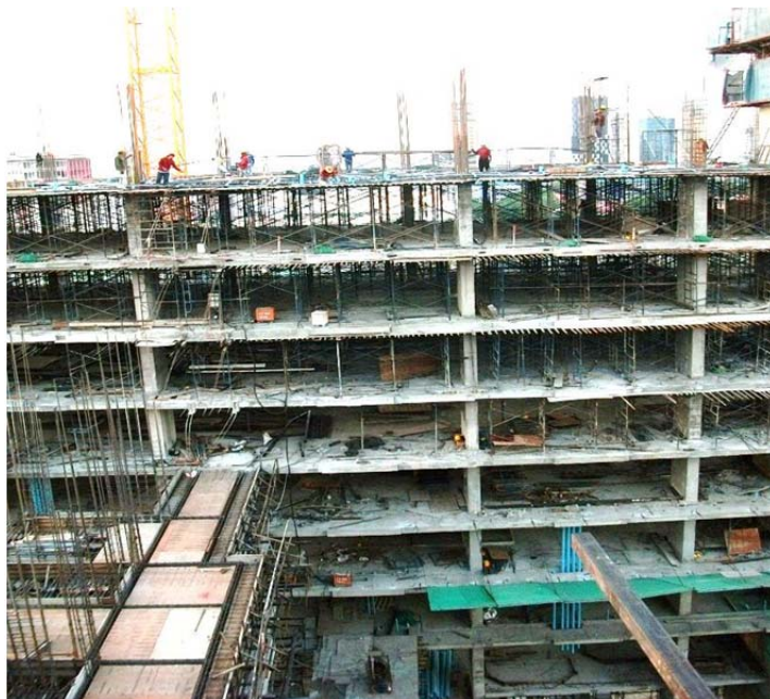
รูปที่ 1.7 หน่วยงานก่อสร้างที่ไม่ติดตั้งอุปกรณ์ป้องกันการตกจากที่สูง
