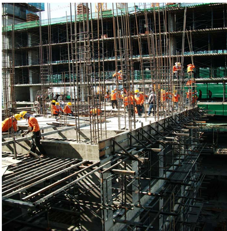
รูปที่ 1.6 การทำงานบนที่สูงโดยไม่ใช้อุปกรณ์ป้องกันการตกจากที่สูง
