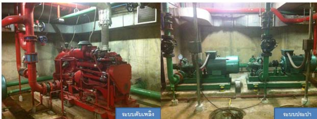
ภาพที่ 3.20 ระบบวิศวกรรมสุขาภิบาลและดับเพลิง อาคารกلاسเฮ้าส์ สุขุมวิท ณ เดือนมกราคม 2556
