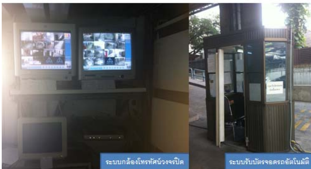
ภาพที่ 3.21 ระบบป้องกันและรักษาความปลอดภัยและอำนวยความสะดวกในอาคาร อาคารกลาสเฮ้าส์ สุขุมวิท ณ เดือนมกราคม 2556
