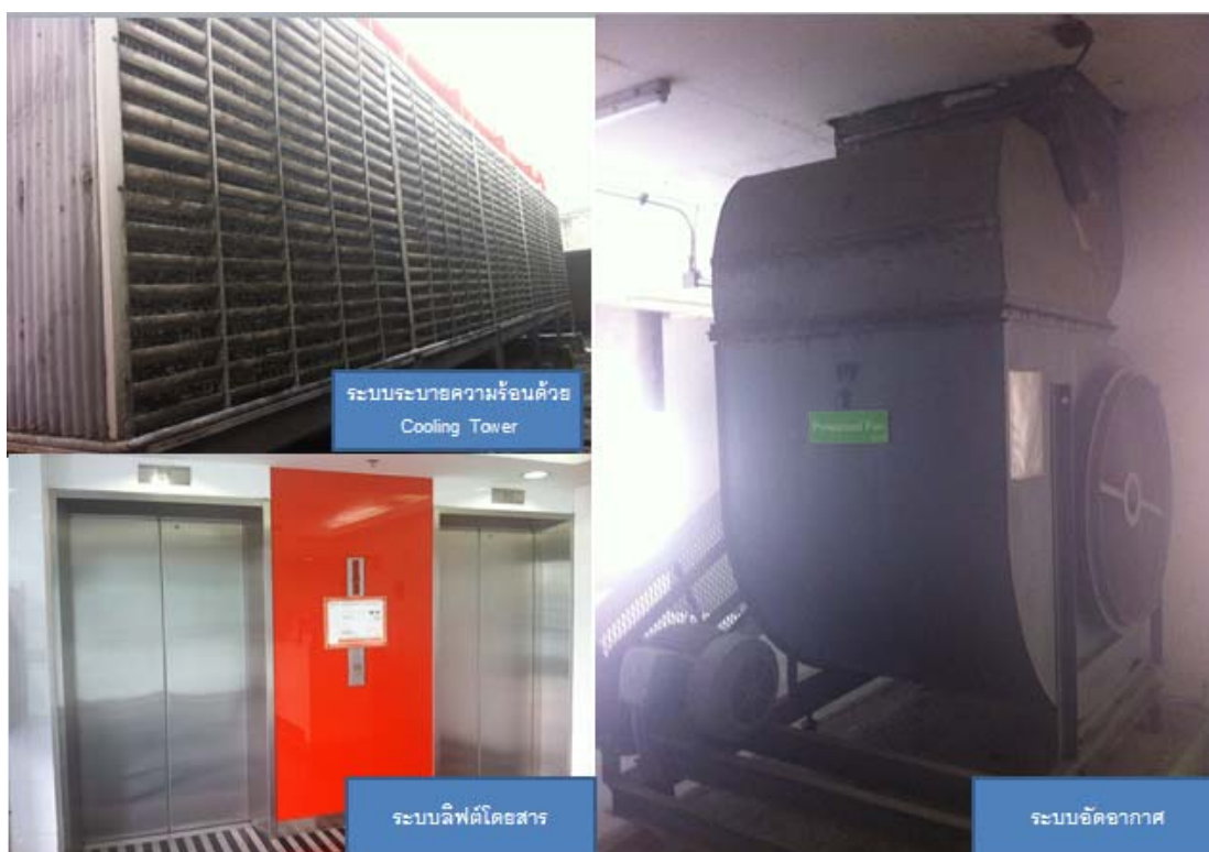
ภาพที่ 3.8 ระบบงานวิศวกรรมเครื่องกล อาคารกลางเข้าสู่ รัชดา ณ เดือนมกราคม 2556
