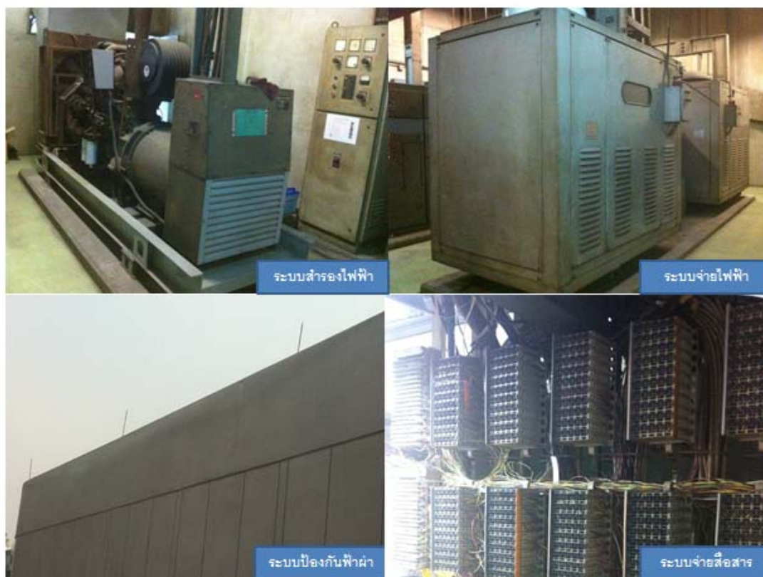
ภาพที่ 3.18 ระบบไฟฟ้าและสื่อสาร อาคารกลาสเฮ้าส์ สุขุมวิท ณ เดือนมกราคม 2556
