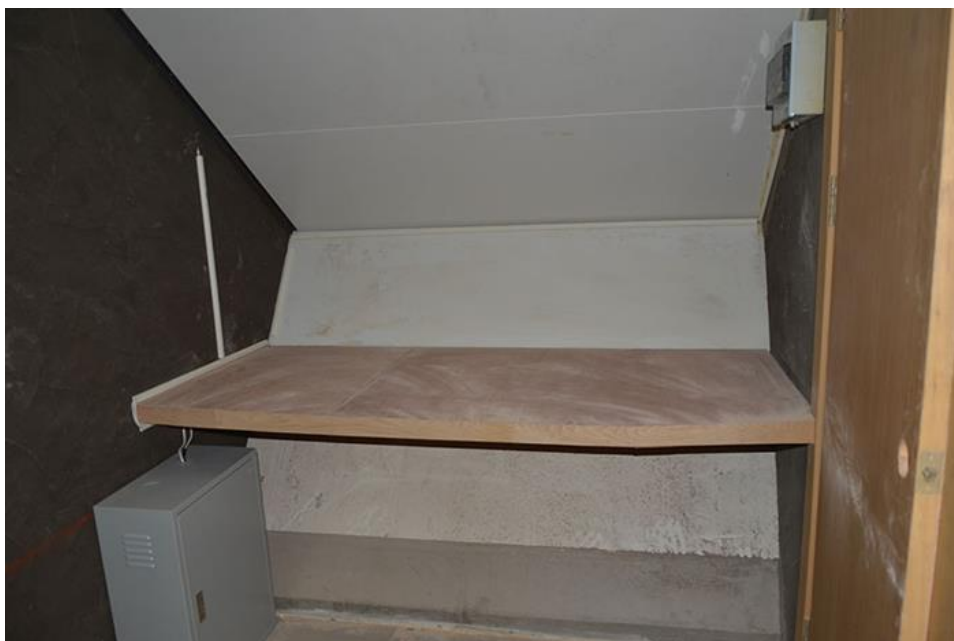
ภาพที่ 4.29 สถานที่เก็บตู้คอนโทรลและตู้จ่ายไฟหลัก
