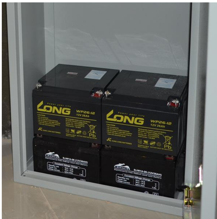
ภาพที่ 4.16 แบตเตอรี่ 4 ลูกขนาด 200 แอมป์ชั่วโมงสำหรับการเก็บจัดเก็บพลังงานไฟฟ้าสำรอง
