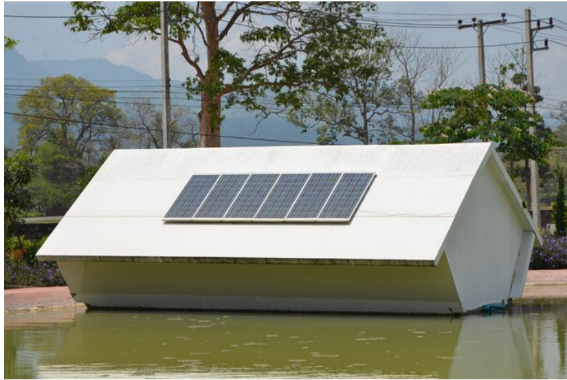
ภาพที่ 4.27 ติดตั้งระบบแผงโซลาร์เซลล์สมบูรณ์พร้อมใช้งาน
