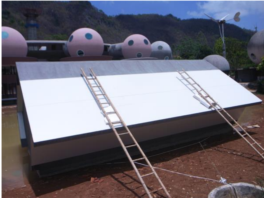
ภาพที่ 4.24 เตรียมการติดตั้งระบบโซลาร์เซลล์บนหลังคาบ้านลอยน้ำ
