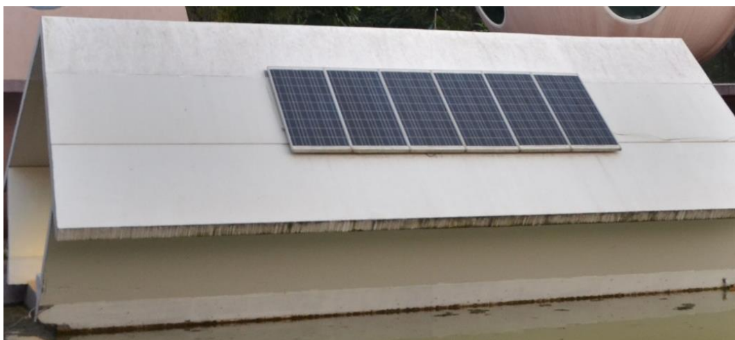
ภาพที่ 4.21 แสดงแผงเซลล์แสงอาทิตย์บนพื้นที่หลังคาบ้านลอยน้ำรวม 6 แผงละ 250 วัตต์
