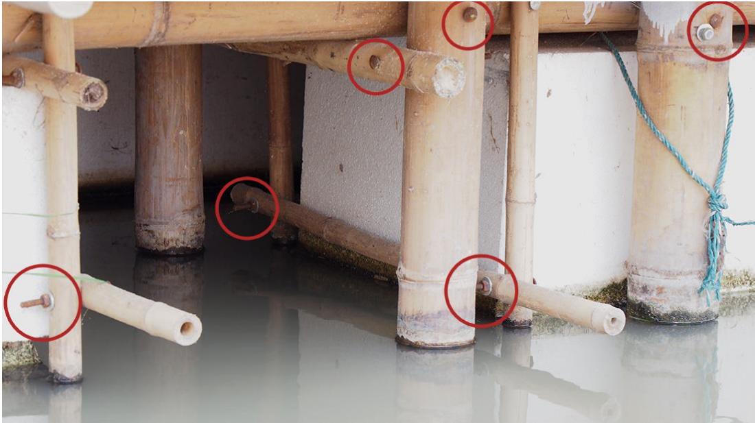
รูปที่ 4.31 นอตและตะปูบริเวณโครงท่อนขึ้นสนิม
