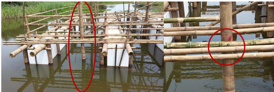
รูปที่ 4.30 เสาในส่วนชานยึดนอตเข้ากับคานแพที่มีขนาดเล็ก
