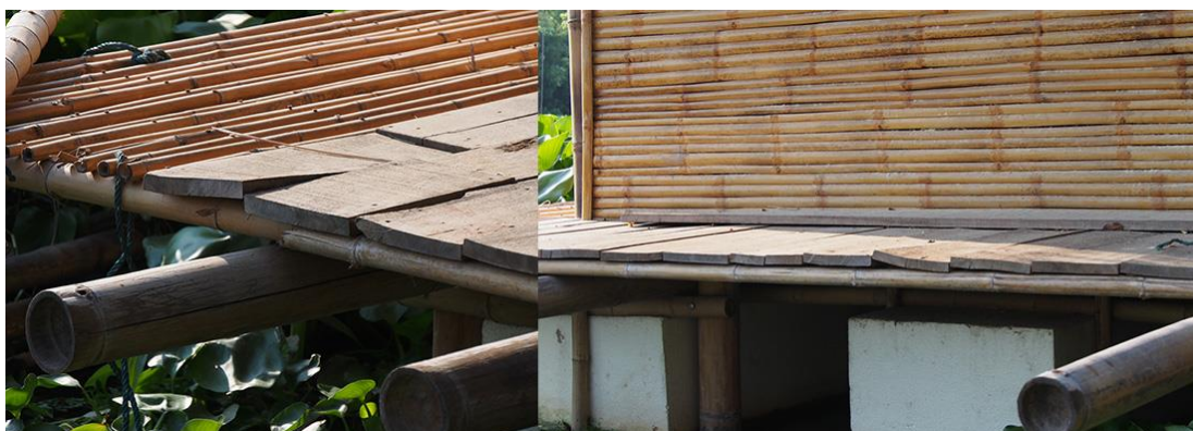
รูปที่ 4.37 พื้นไม้จริงกระดก และบิดตัว
