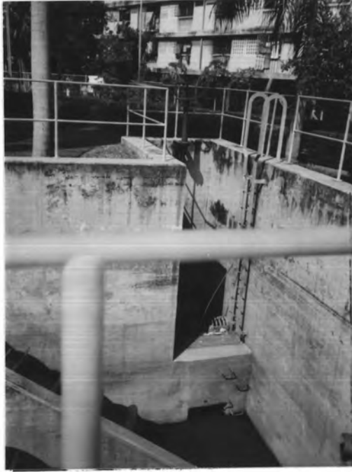
1. บ่อพักน้ำที่ติดตั้งกรวดทราย
