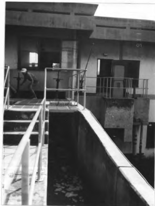
3. รางระบายส่งผ่านน้ำเสีย
