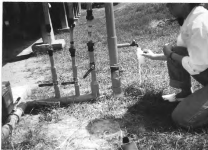
6. เปิดวาล์วให้น้ำเสียเข้าระบบตามอัตราการไหลที่ตั้งไว้ และ เก็บตัวอย่างน้ำ INFLUENT
