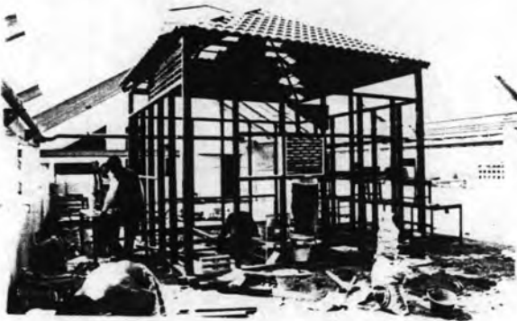
(3) งานโครงสร้างหลังคาและโครงผนังเหล็กแบ่งซอย
