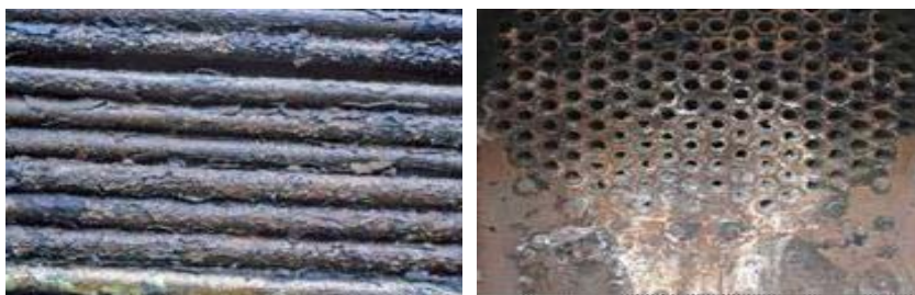
รูปที่ 3.19 Corrosion fouling
