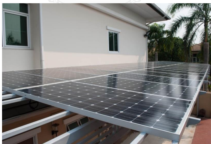
ภาพที่ 2.5 ตัวอย่างการติดตั้งระบบผลิตไฟฟ้าจากเซลล์แสงอาทิตย์ประเภทบนหลังคา ของประเทศไทย
