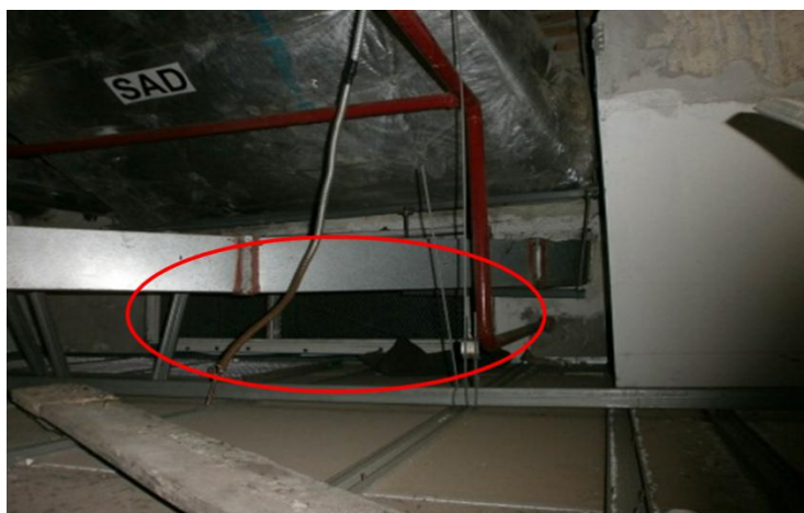
รูปที่ 31 แสดงท่อลมกลับของห้องล้างเครื่องมือแพทย์ไม่ได้ต่อเข้าเครื่องส่งลมเย็น
