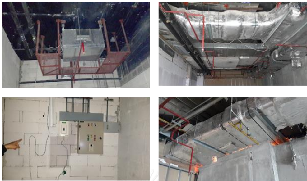
ภาพที่ 8 ตัวอย่างงานระบบในพื้นที่ว่างสำหรับให้เช่าของศูนย์การค้าพาราไดซ์พาร์ค
