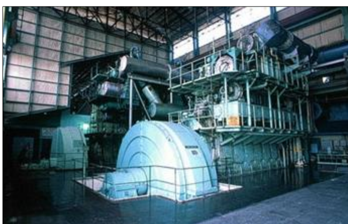
รูปที่ 2.7 โรงไฟฟ้าดีเซล
