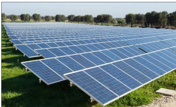
รูปที่ 2.8 โรงไฟฟ้าพลังงานแสงอาทิตย์
