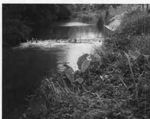
ฝายน้ำล้นที่หมู่บ้านวอเตอร์วิลล์ บริเวณบ้านขุนงพระใต้ อำเภอปากช่อง
