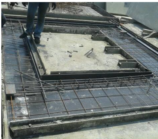
ภาพที่ 3.6 การวางแบบหล่อด้านข้าง และ ตรวจสอบ
