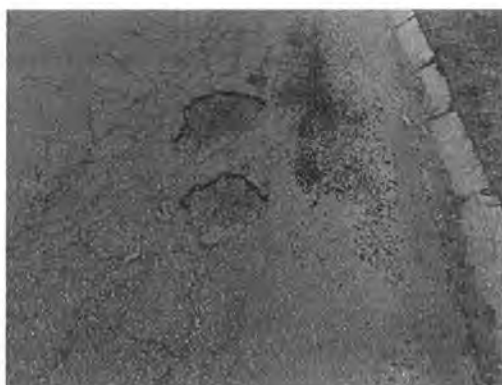
(ค) รอยหลุดร่อน (Raveling)
