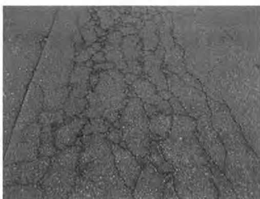
(ก) รอยแตก (Crack)
