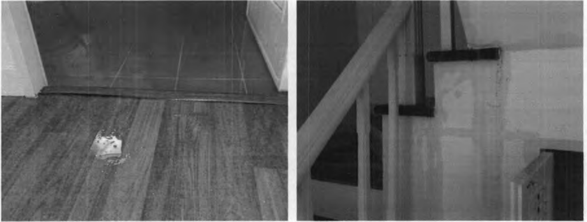
ภาพที่ 5.12 แสดงรอยรั่วของห้องน้ำชั้น 2 ที่รั่วซึม ลงมายังชั้นล่าง
