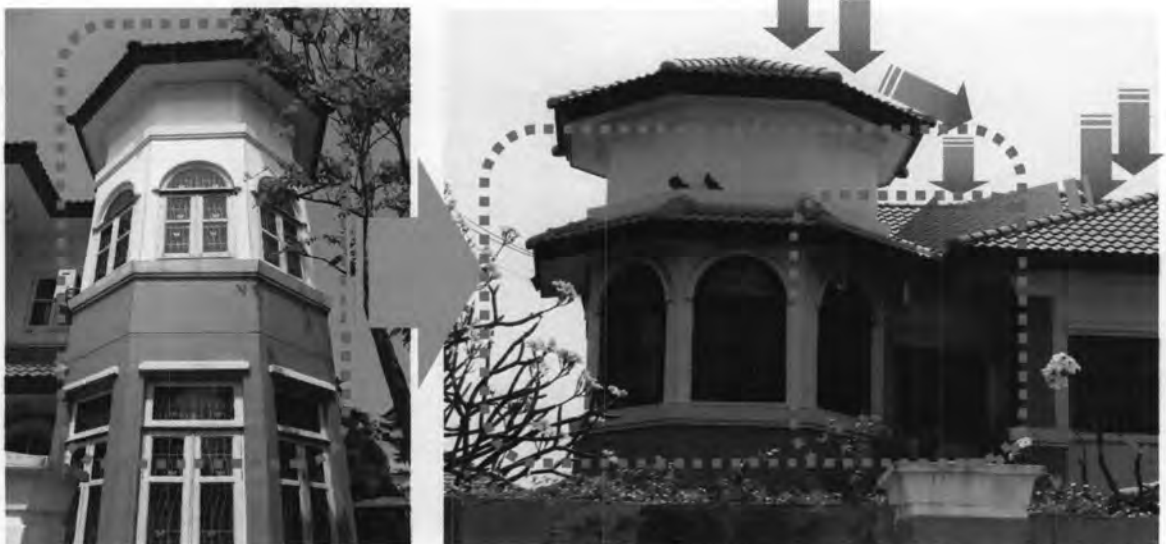
ภาพที่ 5.8 แสดงจุดที่ก่อให้เกิดปัญหารั่วซึม จากน้ำฝนบริเวณภายนอกโดม 8 เหลี่ยมแบบบ้าน C
