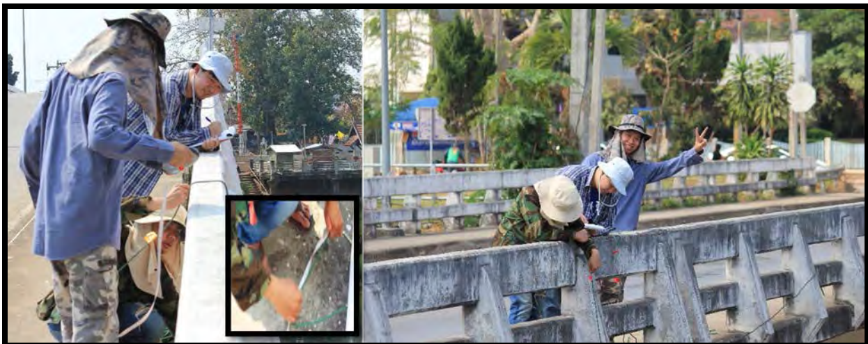
รูปที่ 3.5 แสดงขั้นตอนการวัดขนาดความลึกของร่องน้ำ โดยมีระยะห่างทุกทุก 5 เมตร
