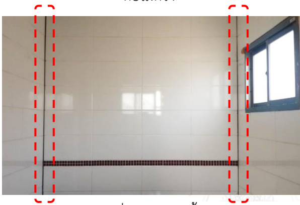
รูปภาพที่ 55 การติดตั้งแผ่นผนังห่าง ทำให้เกิดร่องก่อสร้าง
