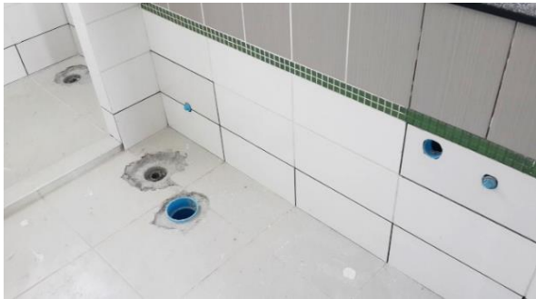
รูปภาพที่ 54 การเว้นตำแหน่งจากโรงงาน ท่อไม่ตรง
