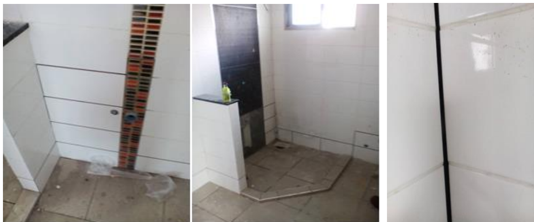
รอยคราบน้ำขังในช่วงทดสอบการระบายน้ำ
