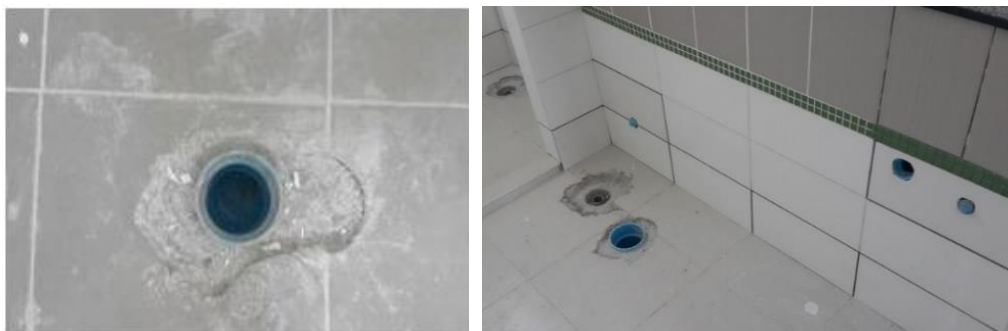
รูปภาพที่ 58 ตำแหน่งท่อน้ำทิ้งและท่อชักโครกไม่ตรงจุดใช้งาน
