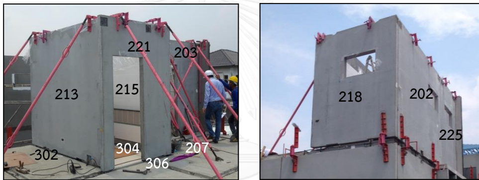
รูปภาพที่ 47 เมื่อติดตั้งผนังสำเร็จรูปแล้วเสร็จของโครงการเดอะแพลนท์ เอสทีค เขตพัฒนาการ ที่มา : ผู้วิจัย, 2558
