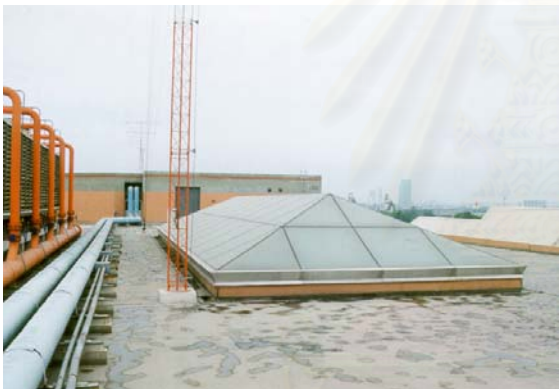
รูปที่ 3.27 แสดงช่องแสงด้านบนบริเวณดาดฟ้าอาคาร
