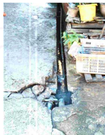
ภาพที่ 5.19 แสดงท่อพีวีซีระบายน้ำมาบรรจบรางเปิด
