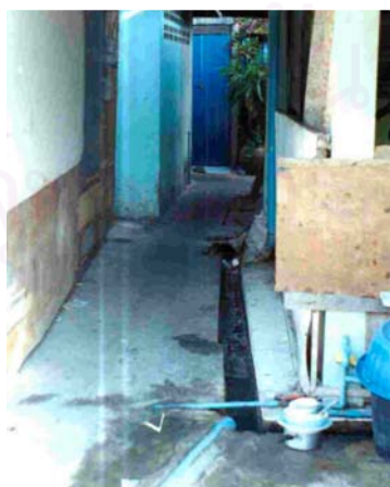
ภาพที่ 5.18 แสดงทางระบายน้ำแบบรางเปิด
