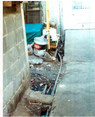
ภาพที่ 5.17 แสดงทางระบายน้ำด้านตะวันตกจะมีปัญหาการอุดตันและเกิดน้ำท่วมบ่อย
