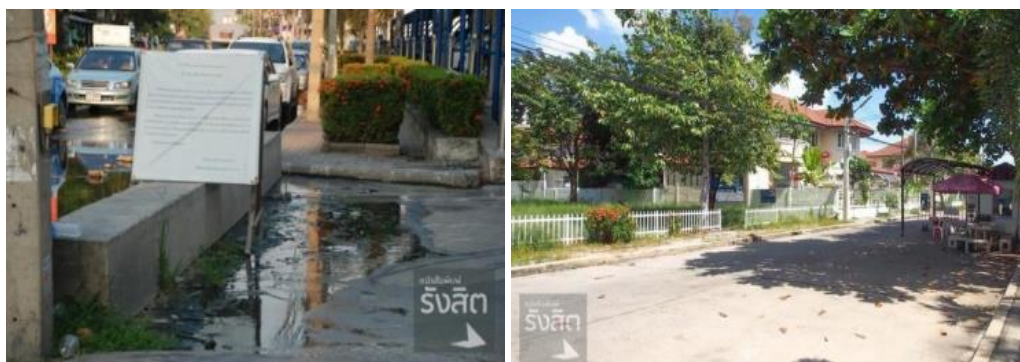
รูปภาพที่ 1 แสดงสภาพหมู่บ้านจัดสรรที่มีสภาพถนนและทางเท้าทรุดโทรม
