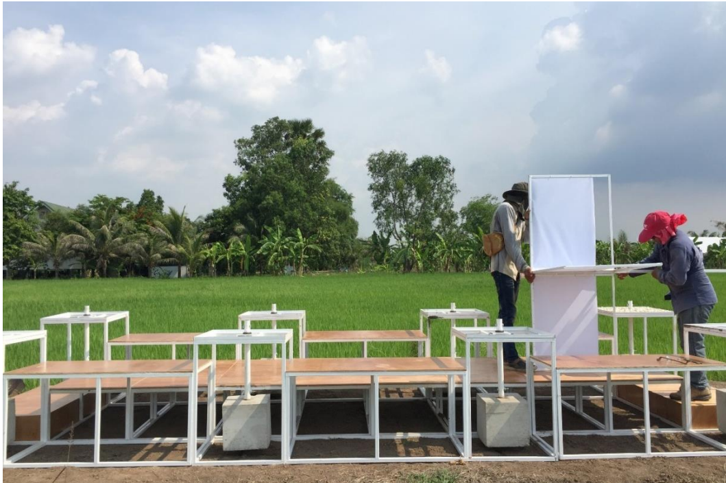
รูป 4-32 ขั้นตอนการติดตั้งศาลาเห็นลมบนคันนา
