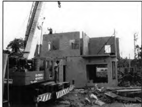
รูปที่ 5.103 แสดงขณะติดตั้งชิ้นส่วนผนังชั้นบน
