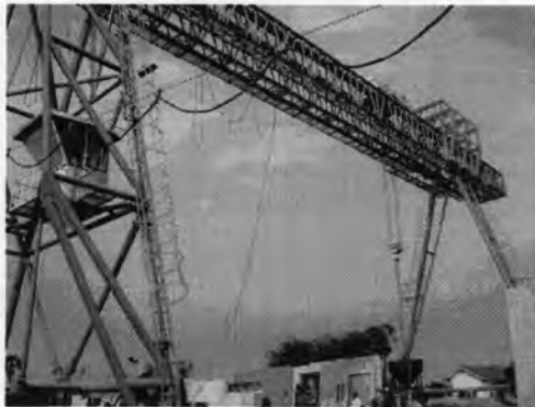
รูปที่ 5.47 แสดงการใช้เครนช่วยในการเทคอนกรีต
