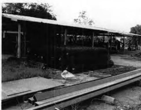
รูปที่ 5.25 ภาพแสดงโรงตัดและตัดเหล็กเสริม
