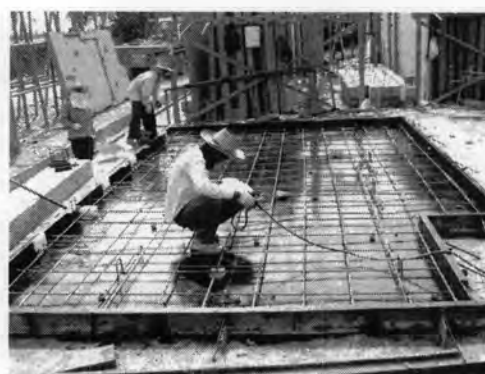
รูปที่ 5.44 แสดงการติดตั้งวัสดุอุปกรณ์ฝัง
