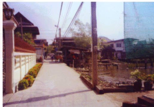
สภาพตลิ่งก่อนปรับปรุง
