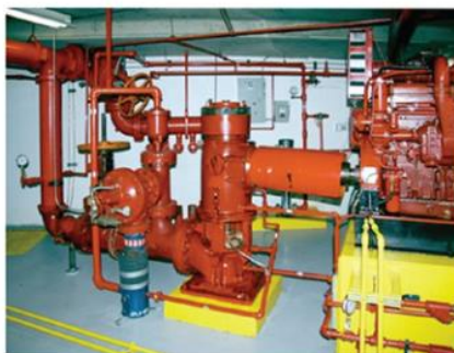
รูปที่ 2. 34 เครื่องสูบน้ำดับเพลิงเทอร์โบแนวตั้ง (Vertical Turbine Pump)
