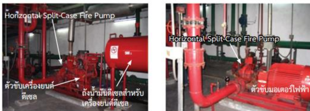
รูปที่ 2. 35 การขับเคลื่อนเครื่องสูบน้ำดับเพลิงด้วยเครื่องยนต์ดีเซล และมอเตอร์ไฟฟ้า
