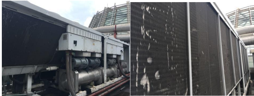
รูปภาพที่ ข- 1 เครื่องทำน้ำเย็นที่ทำการตรวจวัด
