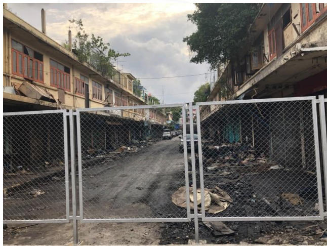
ภาพที่ 13 อาคารพาณิชย์ร้างบริเวณเชียงใหม่
