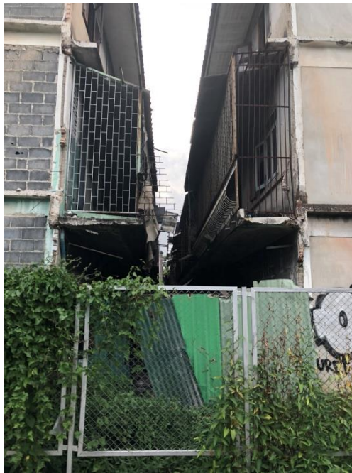
ภาพที่ 12 อาคารพาณิชย์ร้างบริเวณเชียงใหม่
