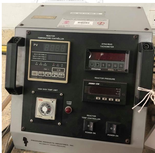
รูปที่ 2.6 แผงควบคุมการทำงาน
