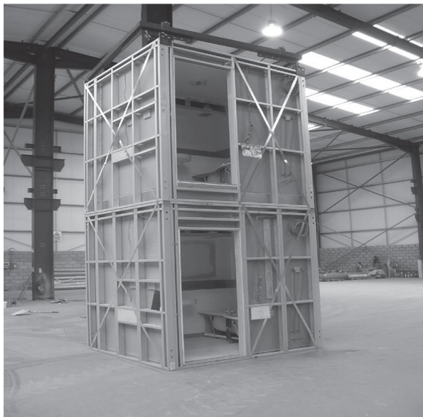
รูปที่ 2.23 โมดูลาร์ที่มีโครงสร้างเป็นเหล็กชนิดไม่เต็มรูปแบบและงานภายในแล้วเสร็จไม่สมบูรณ์ (ที่มา: Lawson et al., 2014)
