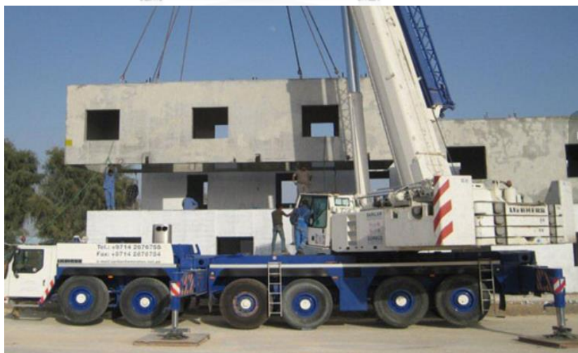
รูปที่ 2.20 โมดูลาร์ที่มีโครงสร้างเป็นคอนกรีตชนิดเต็มรูปแบบและงานภายในแล้วเสร็จไม่สมบูรณ์ (ที่มา: Lawson et al., 2014)
