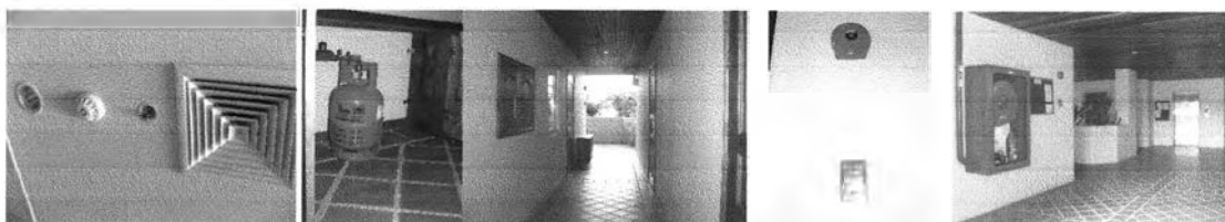
ที่ดูดควัน สปริงเกอร์ ถังแก๊สอยู่นอกห้องและทางเดิน(ชั้นบน) สัญญาณเตือนไฟ สายดับเพลิง
