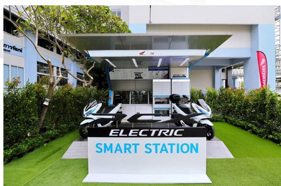
รูปที่ 2-4 สถานีชาร์จไฟฟ้า Electric Smart Station
