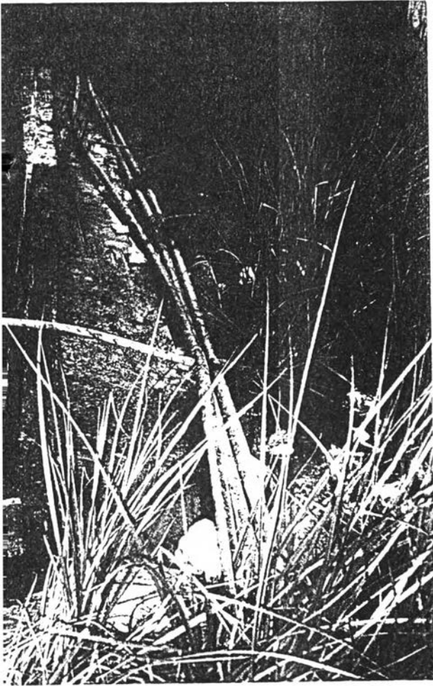
รูปที่ 23 ภาพแสดงระบบท่อน้ำประปาภายใน บ้านพักของกลุ่มบ้านพักแบบ "กระเบื้อง" ซึ่งต่อเชื่อมเข้ากับมิเตอร์น้ำประปาของการประปาส่วนภูมิภาค (ในภาพเป็นกลุ่มบ้านพัก ถ.ศรีสมาน - ตค.41)
