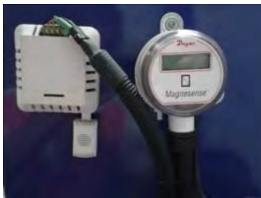
รูปที่ 4 - 12 การติดตั้งอุปกรณ์วัดอุณหภูมิและความดันบรรยากาศ
