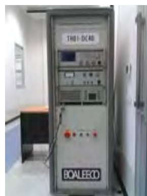
รูปที่ 4 - 5 ชุดควบคุม ยี่ห้อ BOALEECO
