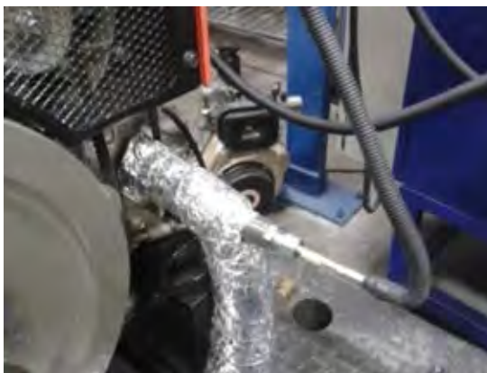
รูปที่ 4 - 10 การติดตั้งเทอร์โมคัปเปิลเพื่อวัดอุณหภูมิไอเสีย
