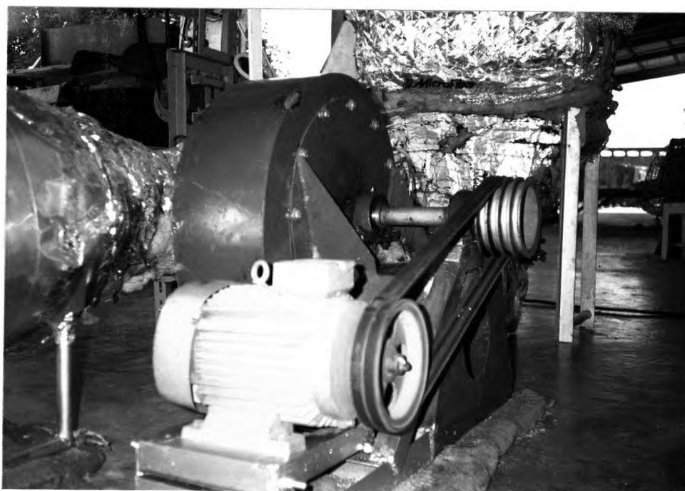
รูปที่ 3.7 เครื่องเป่าอากาศ
