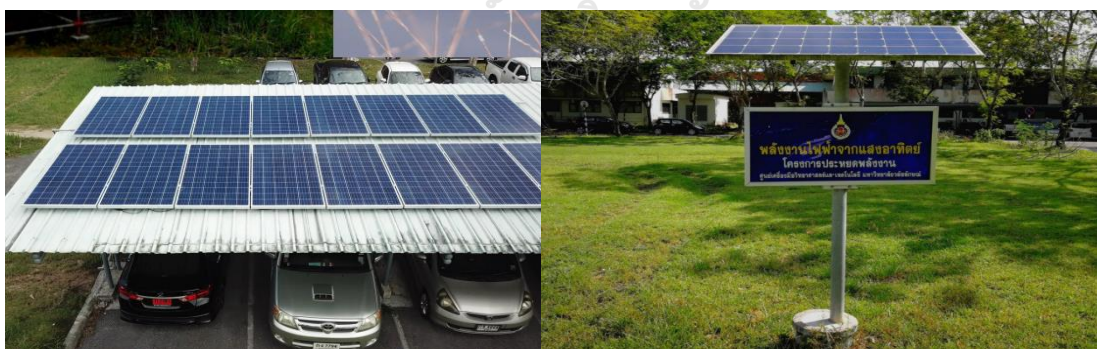
ภาพที่ 5.9 พลังงานแสงอาทิตย์บริเวณหลังคาที่จอดรถศูนย์บรรณศาสตร์
