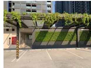
บริเวณที่จอดรถ พบการปลูกไม้เลื้อยบนหลังคาถ้ำกันสาด
