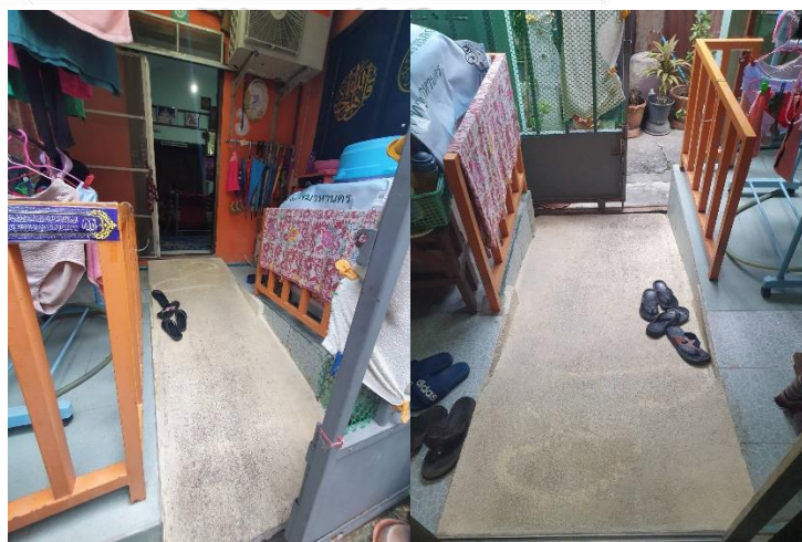
ภาพที่ 105 พื้นที่เฉลียงหน้าบ้าน กรณีศึกษาหลังที่ 25 พื้นที่เฉลียงหน้าบ้านเป็นทางลาดไว้อยู่แล้วมีความชัน 1:8 ถือว่าค่อนข้างชันแต่ถูก บังคับด้วยข้อจำกัดทางพื้นที่
