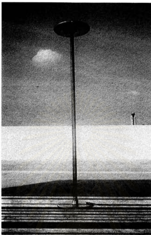
รูปที่ 3.25 การติดตั้งเสาอากาศแบบจานกลมที่ใช้กับเครื่องนับฟ้าผ่าซ้ำ
