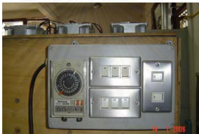
รูปที่ 3.4 พัดลมระบายความร้อนและอุปกรณ์ควบคุมการเปิด-ปิดไฟ
