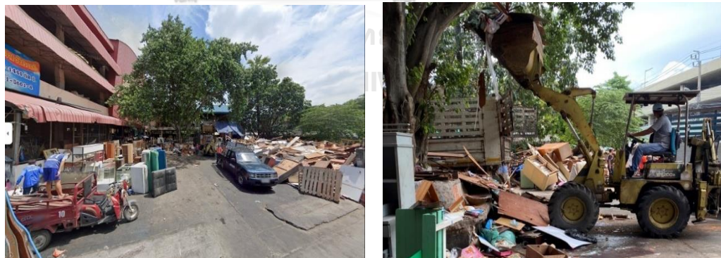
ภาพที่ 4-9 แสดงจุดคัดแยกเศษวัสดุก่อสร้างมือสองในมูลนิธิสวนแก้ว
