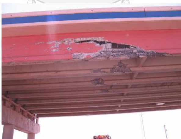
รูปที่ 14 แสดงความเสียหายที่เกิดขึ้นกับสะพานลอยจากรถบรรทุก OS/OW ที่ US 385 at SH 158—Odessa District ที่มา: TxDOT Odessa District
