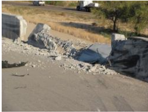
รูปที่ 15 แสดงความเสียหายของสะพานที่ IH20 & PR 41 ที่มา: TxDOT Odessa District
