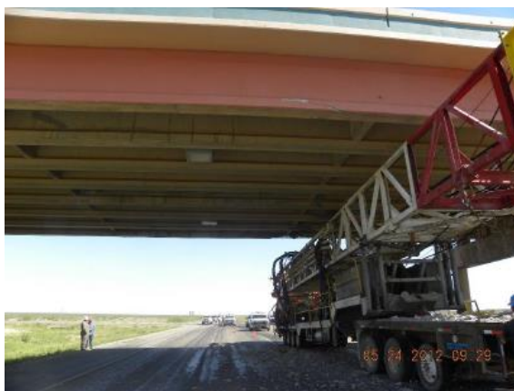
รูปที่ 13 แสดงความเสียหายที่เกิดขึ้นกับสะพานลอยจากรถบรรทุก OS/OW ที่ US 385 at SH 158—Odessa District ที่มา: TxDOT Odessa District
