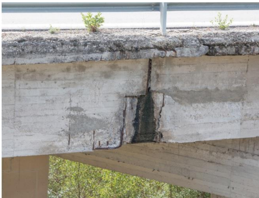
รูปที่ 1.2 ตัวอย่างความเสื่อมสภาพของคอนกรีตที่เสียหายจากการถูกกัดกร่อน (Santarsiero et al., 2021)
