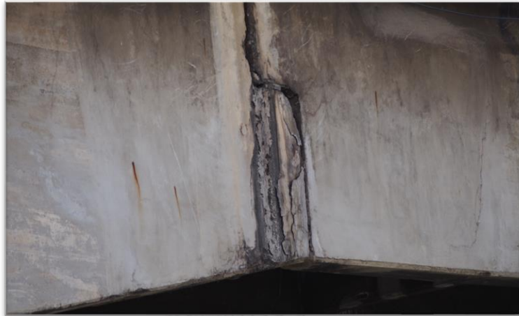
รูปที่ 3.9 รอยแตกร้าวจากการสำรวจฝั่งวังน้อย 1
