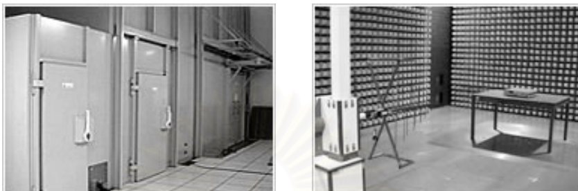
รูปที่ 3.1 ห้องปิดกั้นกึ่งไร้คลื่นสะท้อนแม่เหล็กไฟฟ้า (Semi Anechoic Chamber)
